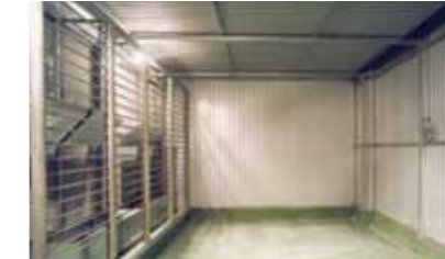
オゾン発生器と凍結室
