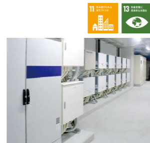
気仙沼ソーティングスポットの蓄電池
